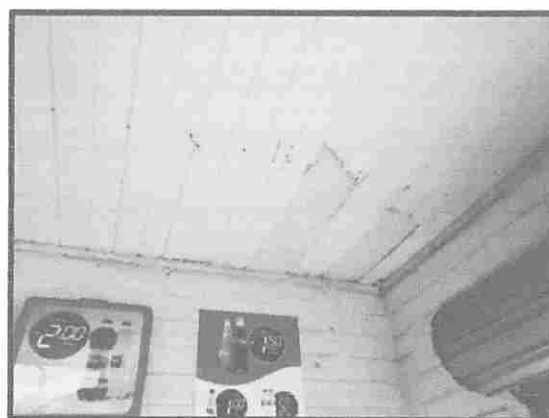
Imagem 03: Infiltração no forro
