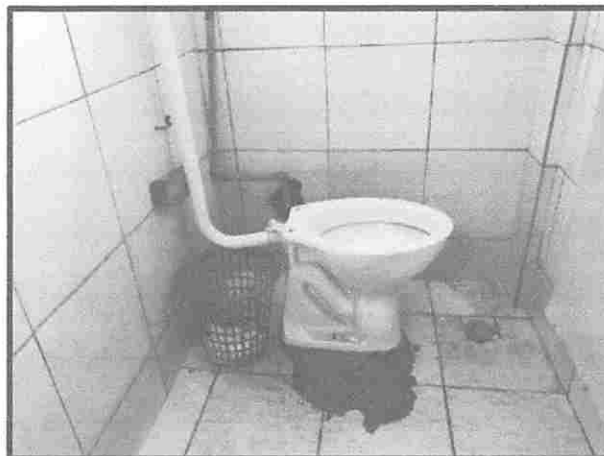
Imagem 07: Infiltração em sanitário
