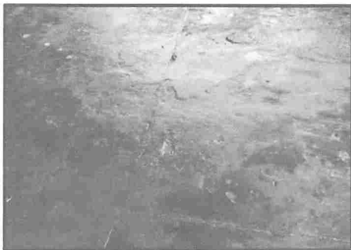
Imagem 26: Fissura em telha fibrocimento
