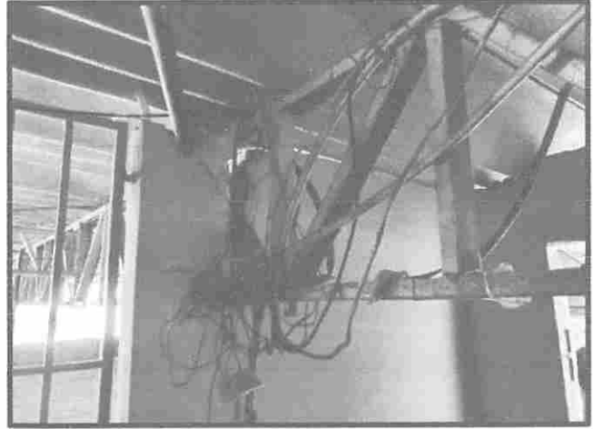
Imagem 15: Fiação exposta em treliça
