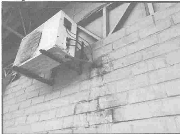
Imagem 18: Dreno de ar-condicionado
