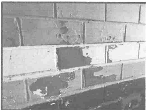
Imagem 04: Infiltração em alvenaria
