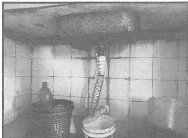
Imagem 06: Infiltração em pia
