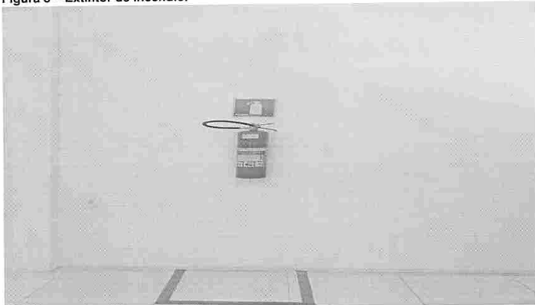
Figura 3 – Extintor de incêndio.
